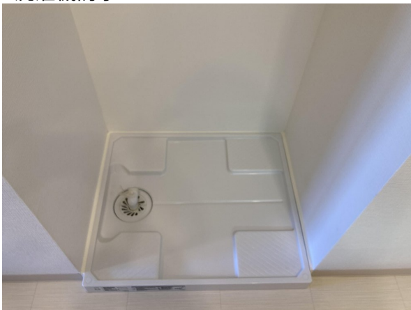
7.洗濯機防水パン
