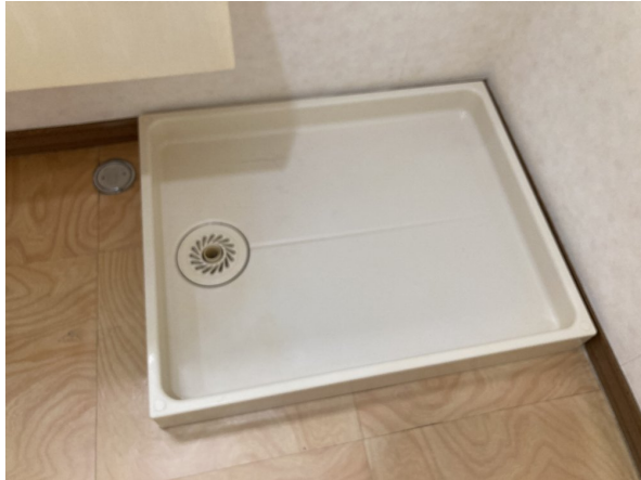
7.洗濯機防水パン
