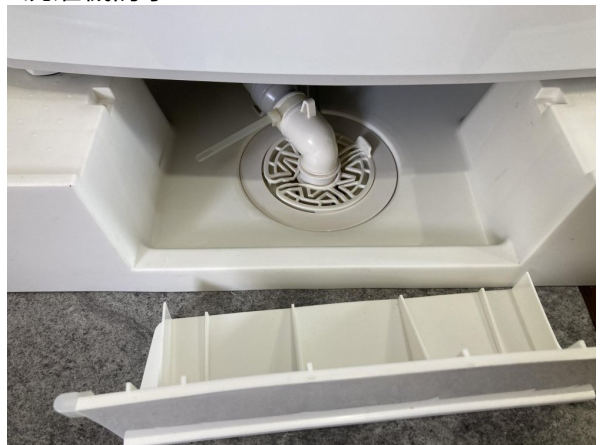
5.洗濯機防水パン
