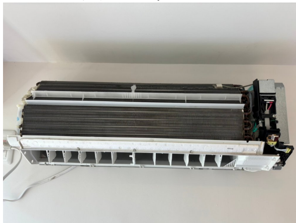
16.エアコンクリーニング
