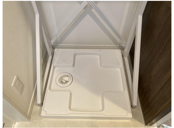
8.洗濯機防水パン
