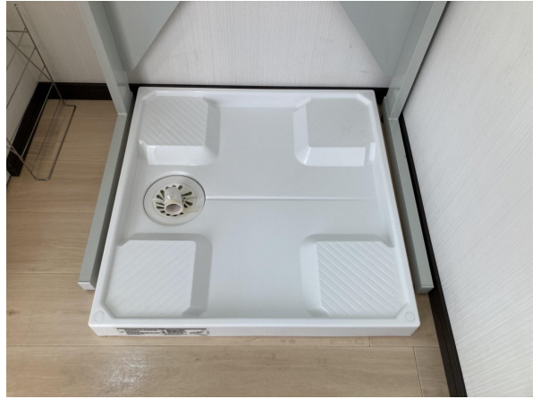
8.洗濯機防水パン
