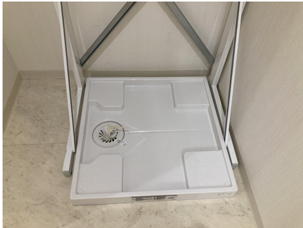
8.洗濯機防水パン
