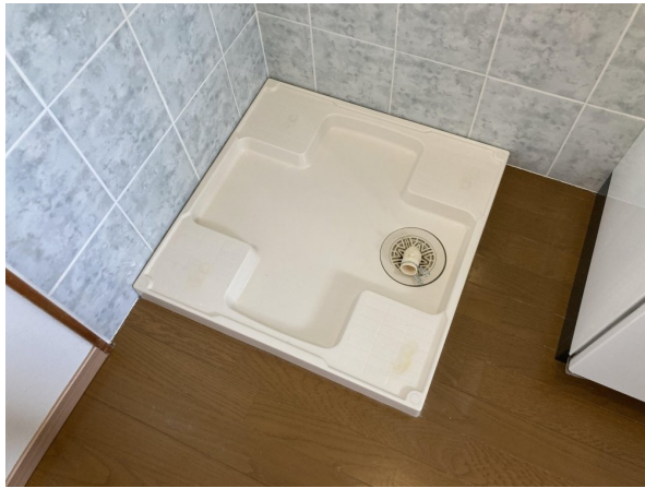
7.洗濯機防水パン
