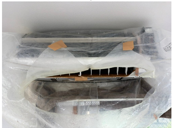
15.エアコンクリーニング
