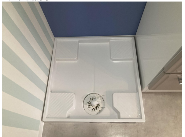
6.洗濯機防水パン
