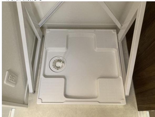
8.洗濯機防水パン
