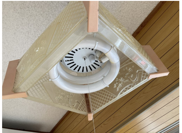
奥の和室の照明、電球切れ
