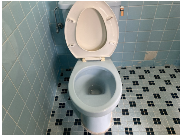
便座ゴム破損、無い所あります
