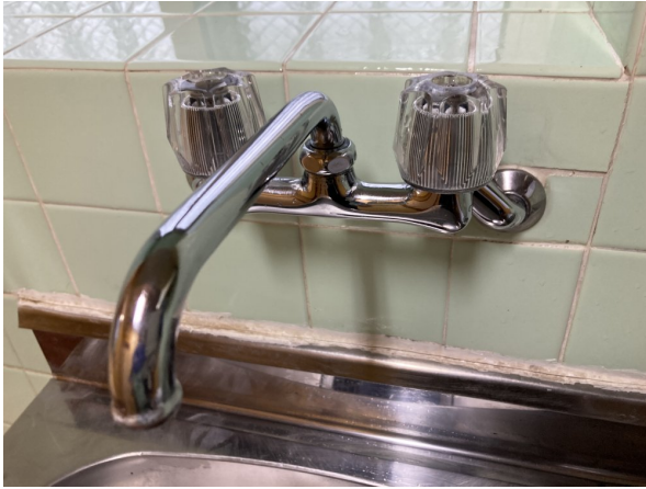
キッチンの混合栓水漏れ
