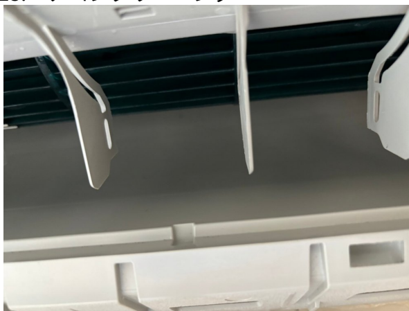
13.エアコンクリーニング
