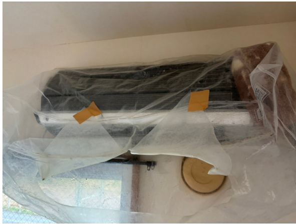
13.エアコンクリーニング
