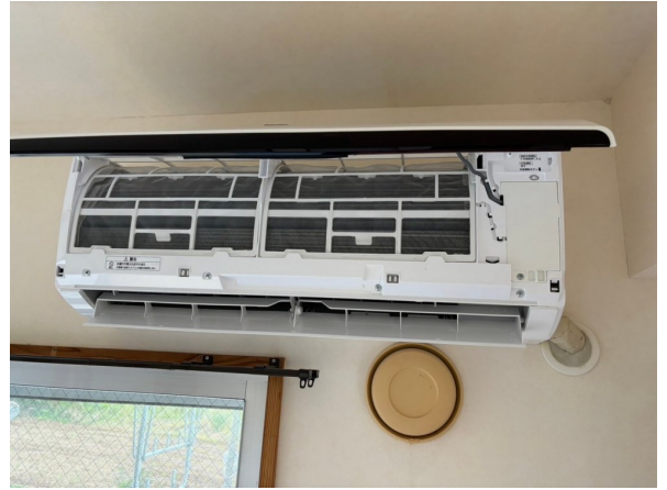
13.エアコンクリーニング
