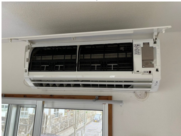
16.エアコンクリーニング
