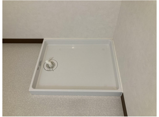
8.洗濯機防水パン
