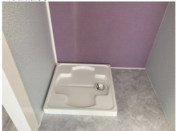
5.洗濯機防水パン
