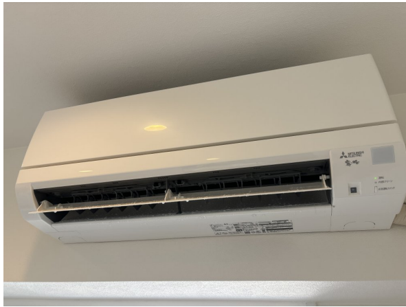
17.エアコンクリーニング
