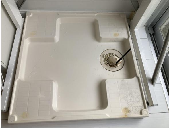
8.洗濯機防水パン
