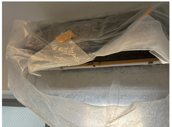
17.エアコンクリーニング
