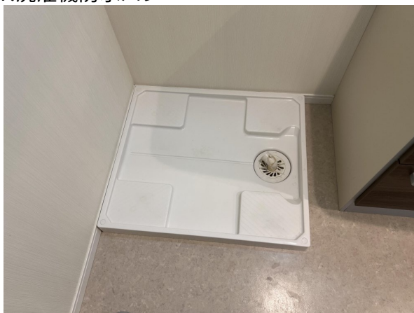
7.洗濯機防水パン
