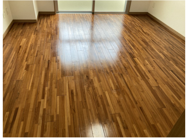
リビングの床にキズ有り
