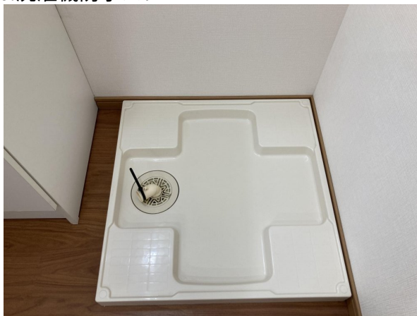
6.洗濯機防水パン
