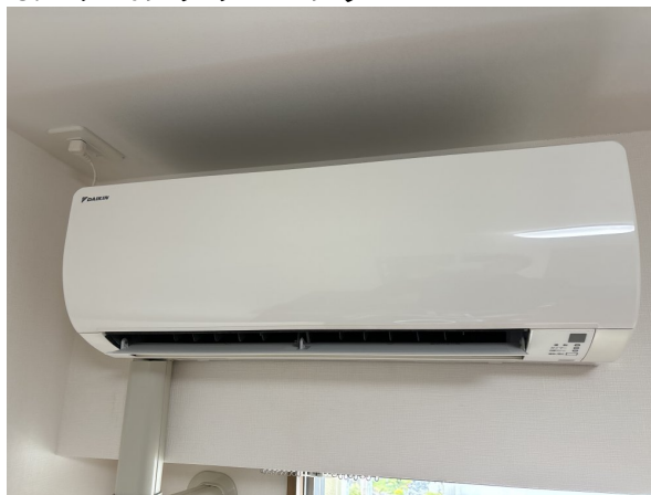
13.エアコンクリーニング
