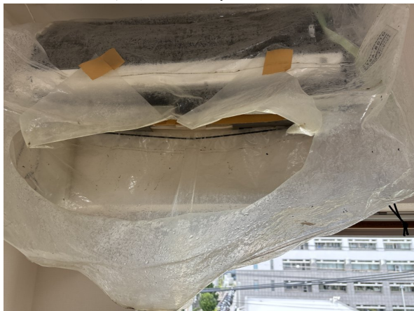
13.エアコンクリーニング
