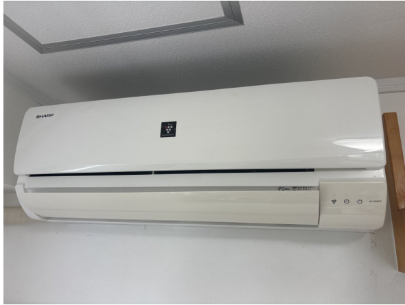
14.エアコンクリーニング
