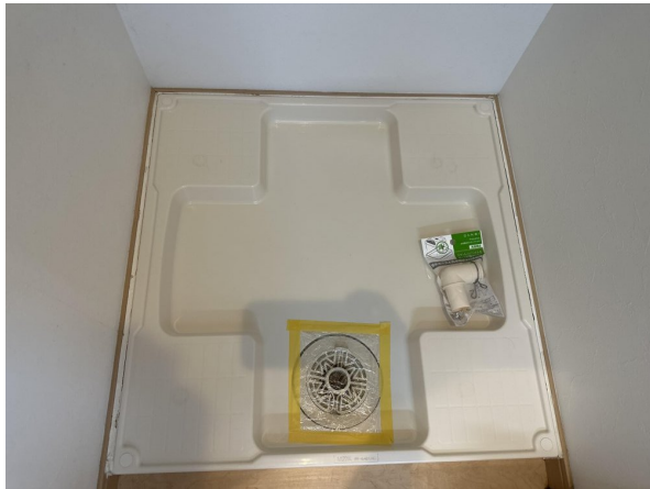
6.洗濯機防水パン
