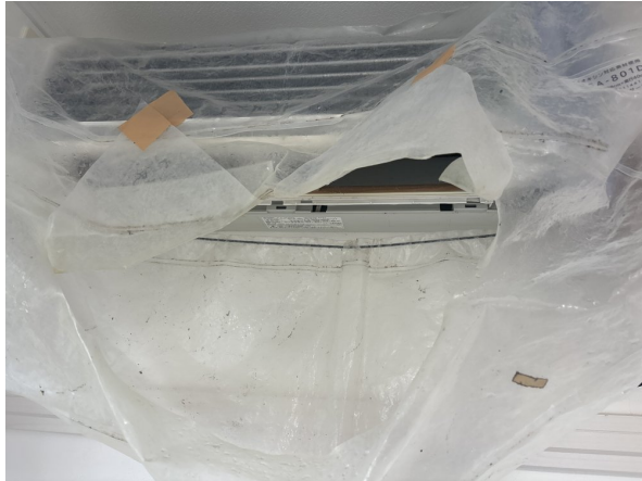
14.エアコンクリーニング
