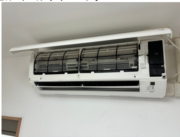
17.エアコンクリーニング
