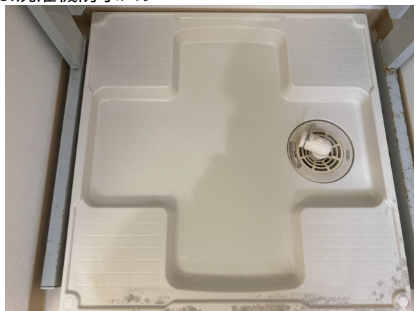
8.洗濯機防水パン
