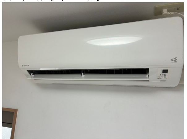
17.エアコンクリーニング
