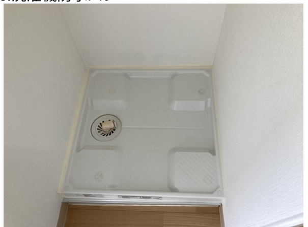
6.洗濯機防水パン
