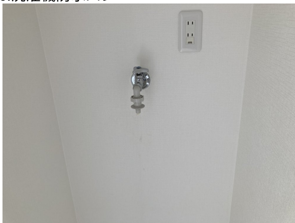
6.洗濯機防水パン
