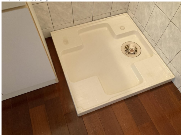
6.洗濯機防水パン
