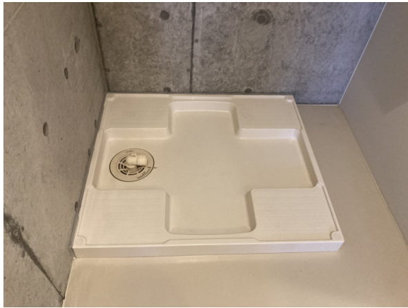
7.洗濯機防水パン
