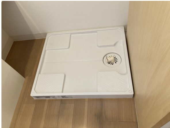
7.洗濯機防水パン
