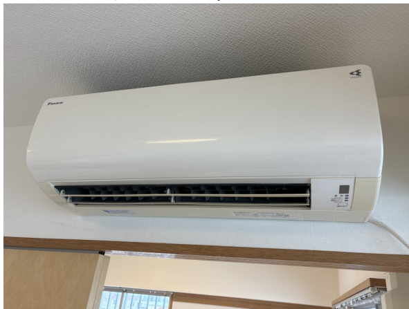
17.エアコンクリーニング
