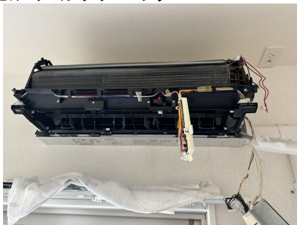
17.エアコンクリーニング
