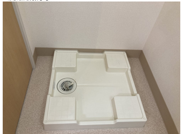
7.洗濯機防水パン
