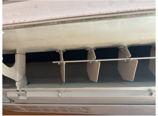
14.エアコンクリーニング
