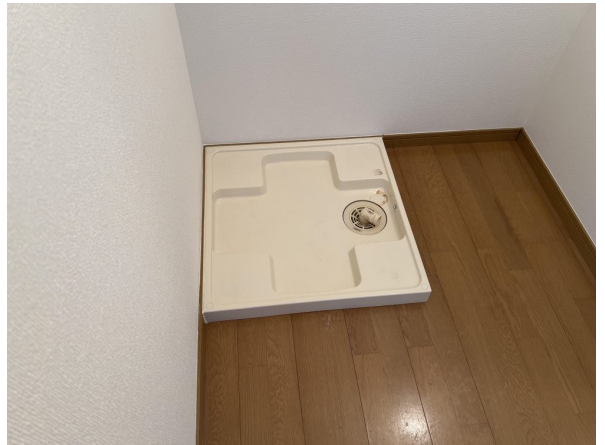
7.洗濯機防水パン
