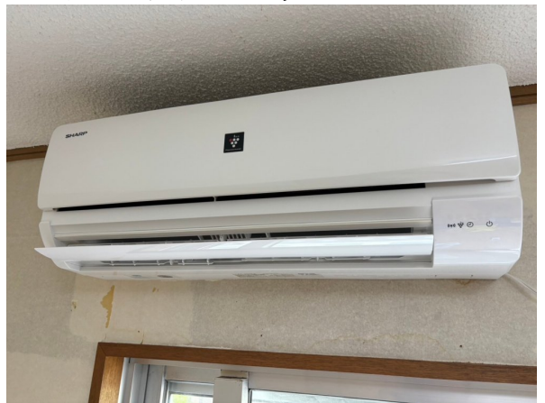
15.エアコンクリーニング
