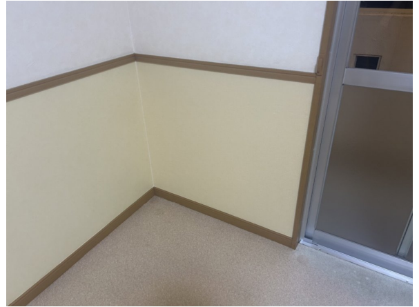
クロス一部張替済み
