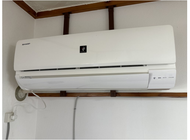
15.エアコンクリーニング
