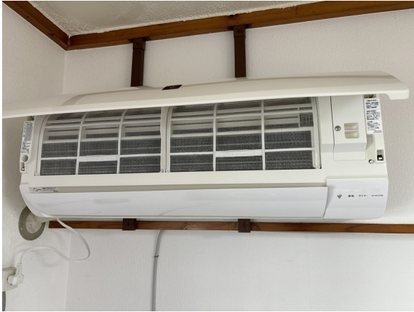
15.エアコンクリーニング
