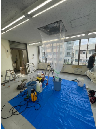
5.エアコンクリーニング
