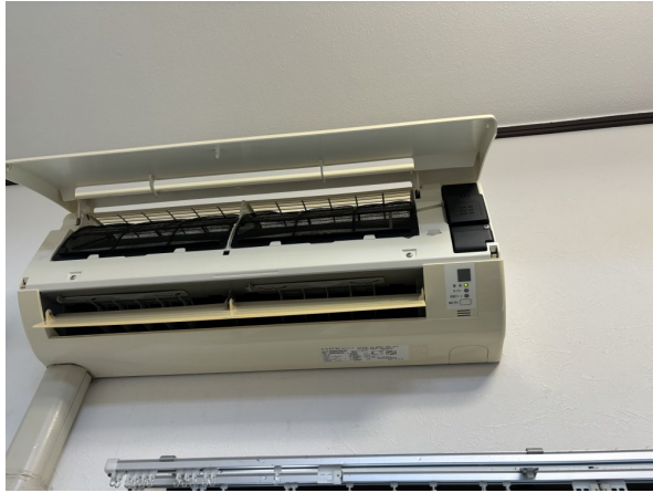
14.エアコンクリーニング
