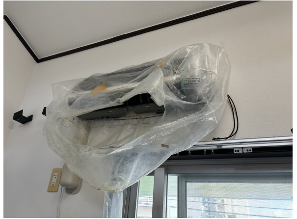
14.エアコンクリーニング
