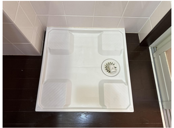
7.洗濯機防水パン
