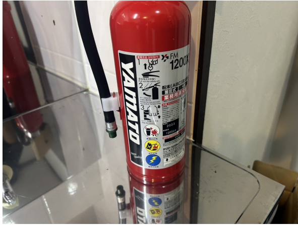
消火器取替済み
