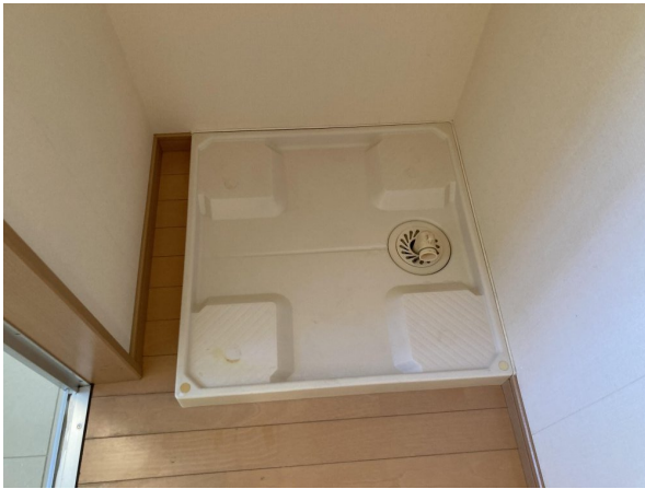
7.洗濯機防水パン
