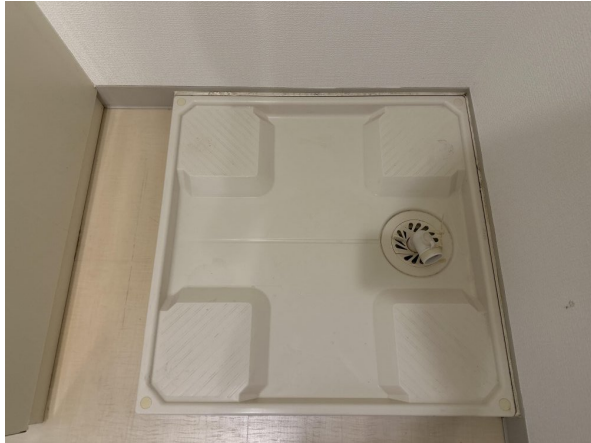
6.洗濯機防水パン
