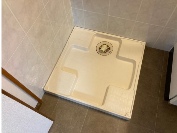
8.洗濯機防水パン
