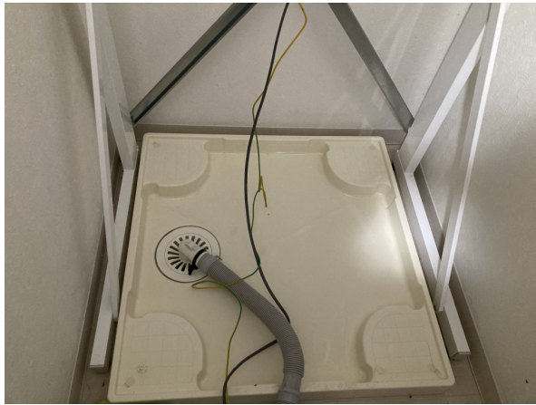
5.洗濯機防水パン
