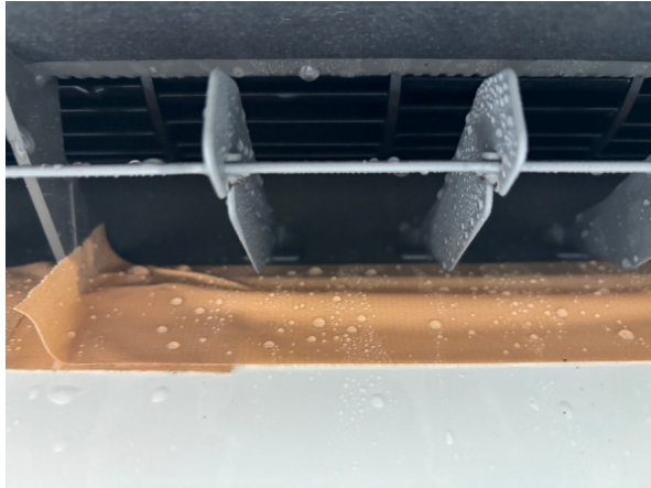
13.エアコンクリーニング
